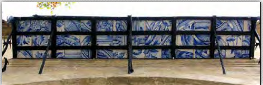
Restes d'un paviment de taulells a les volades dels balcons de l'antiga Casa de la Vila d'Alcoi.
