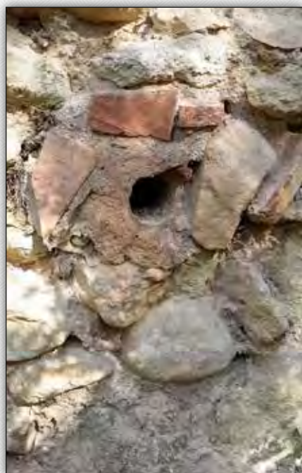
Acometida interior de agua.
